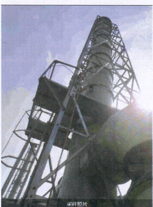
DA007 废气排气筒
