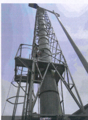
DA008 废气排气筒
