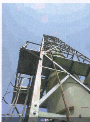
DA003 粘晶车间废气塔
