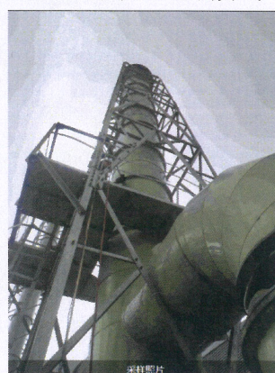
DA009 废气排气筒
