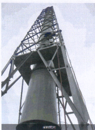
DA010 废气排气筒
