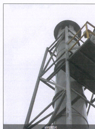
DA005 污水处理站废气
